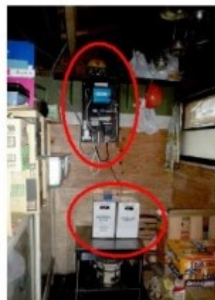
上=制御装置 下=蓄電池 蓄電池=006V×2直列=0012V 103[AH/14h]
