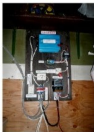
制御装置 (手製) 出力=AC100V 120W 光センサによる自動運転
